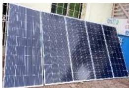
Les panneaux solaires PV
